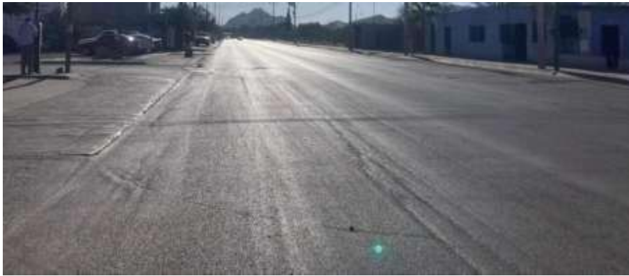
Fig. 3. Pavimento con deformación permanente
