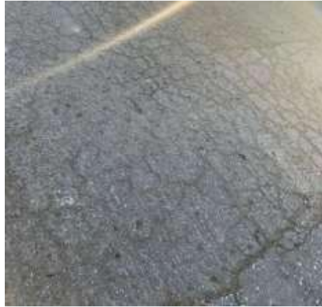
Fig. 4. “Piel de cocodrilo”. Agrietamiento por fatiga
