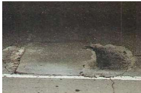
Figura 28. Deterioro en parche (Perez, 2022).
