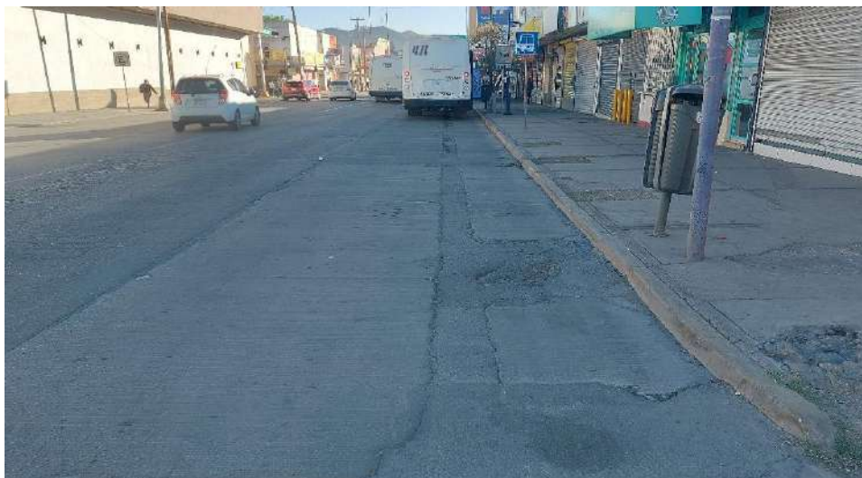
Figura 115. Evidencia del estado de deterioro de uno de los carriles de bus urbano.
