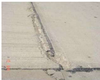
Figura 46. Desportillamiento de juntas (INVIAS, 2013).
