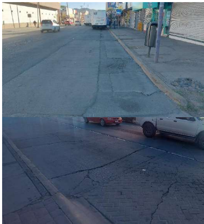
Figura 122. Falla en concreto hidráulico – ejemplo 1 (Sanabria, 2023)
