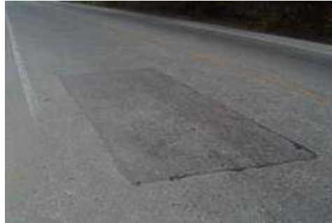
Figura 27. Deterioro en parche (INVIAS, 2013).
