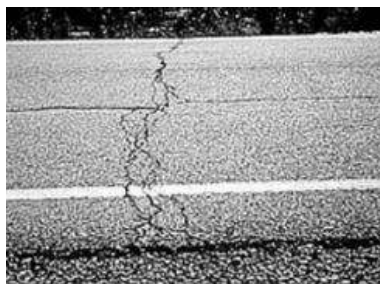
Figura 34. Grietas transversales (INVIAS, 2013).
