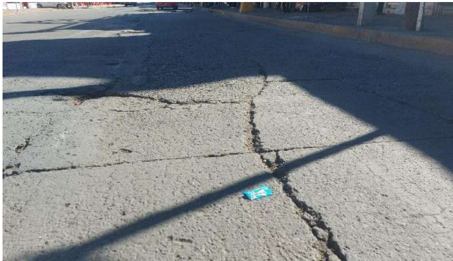
Figura 40. Grietas en bloque (Sanabria, 2023)
