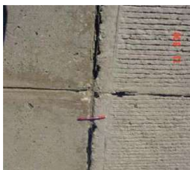
Figura 45. Deterioro de sello o daños en el sello (INVIAS, 2013)
