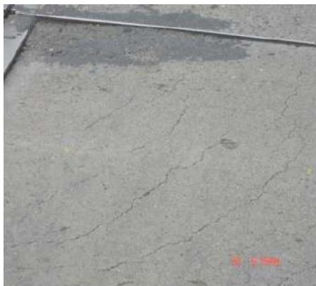
Figura 56. Fisuras ligeras de aparición temprana. (INVIAS, 2013)
