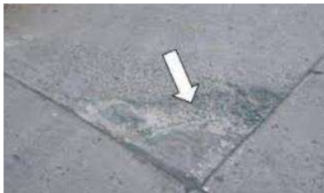
Figura 49. Bache en Pavimento Rígido (Pacheco, 2021).
