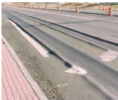
Figura 25. Desplazamiento longitudinal o crestas longitudinales (Perez, 2022).
