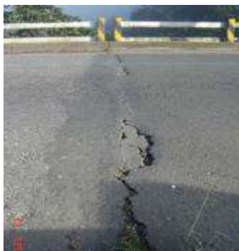
Figura 29. Grietas por reflexión (INVIAS, 2013).
