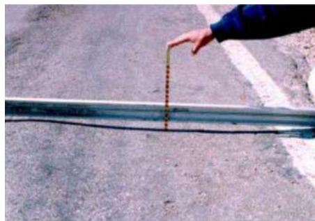
Figura 24. Roderas o ahuellamientos (IMT, 2016).
