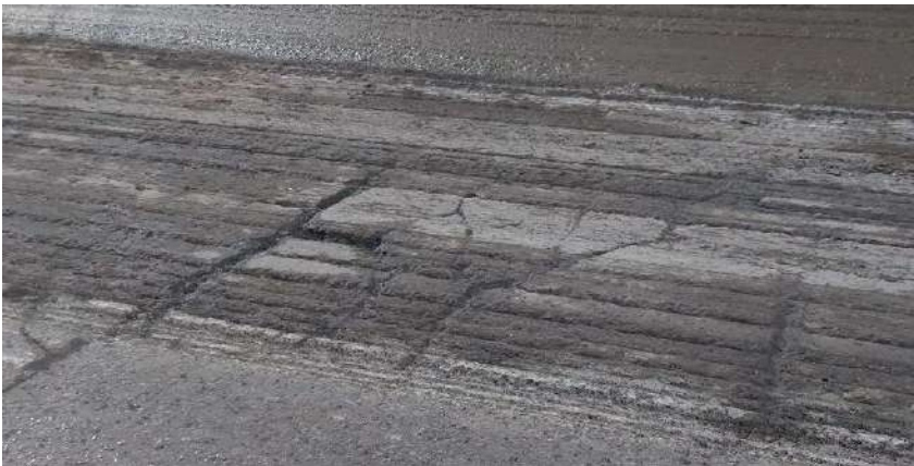
Figura 121. Evidencia de fallas en capas inferiores a la capa tratada (Sanabria, 2023).
