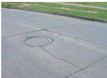
Figura 41. Grietas en pozos (Toxement, 2012).
