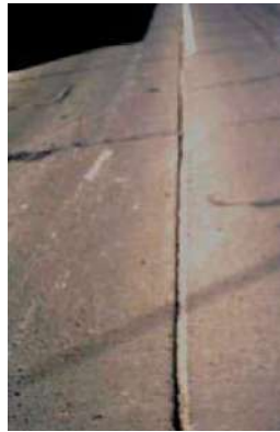
Figura 44. Separación de juntas longitudinales (INVIAS, 2013)
