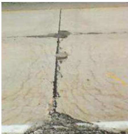
Figura 42. Grietas de durabilidad (Grietas D).
