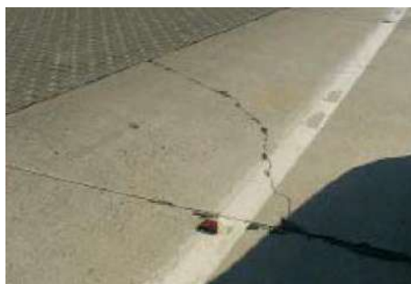
Figura 36. Grieta de esquina (INVIAS, 2013).
