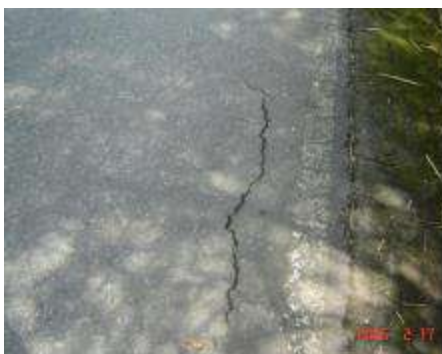
Figura 31. Grietas o fisuras de borde (INVIAS, 2013).
