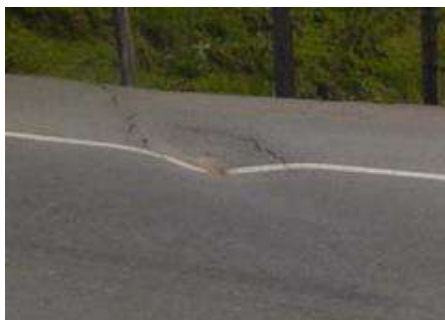
Figura 23. Hundimiento o asentamiento transversal /longitudinal (INVIAS, 2013).
