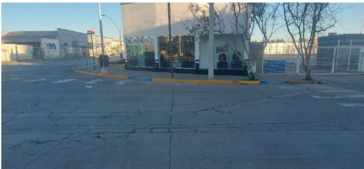
Figura 114. Evidencia de daños superficiales en pavimentos rígidos.
