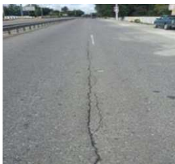
Figura 33. Grieta longitudinal (Perez, 2022).
