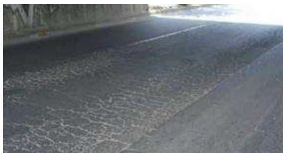
Figura 35. Agrietamiento tipo mapa – grietas de bloque (Perez, 2022).
