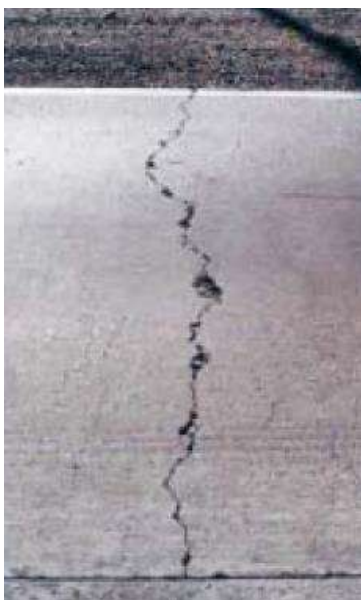
Figura 38. Grieta Longitudinal (INVIAS, 2013).
