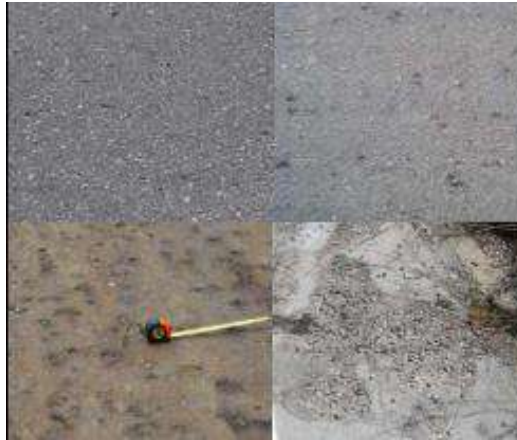
Figura 18. Desprendimiento de agregado (INVIAS, 2013).
