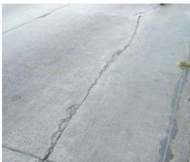
Figura 37. Grieta longitudinal (INVIAS, 2013).
