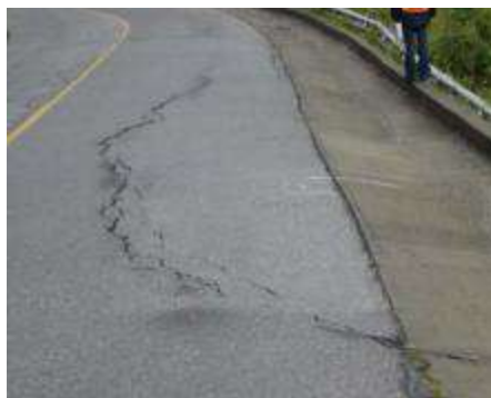
Figura 30. Agrietamiento parabólico o grieta en media luna (INVIAS, 2013).
