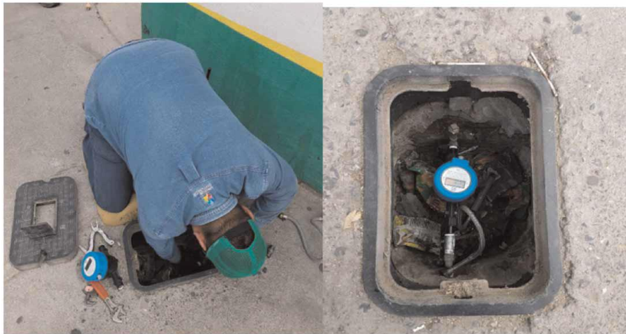
Figura 3.3 | Instalación del medidor Contazara CZ4000(Mendoza & Navarro 2022) .
