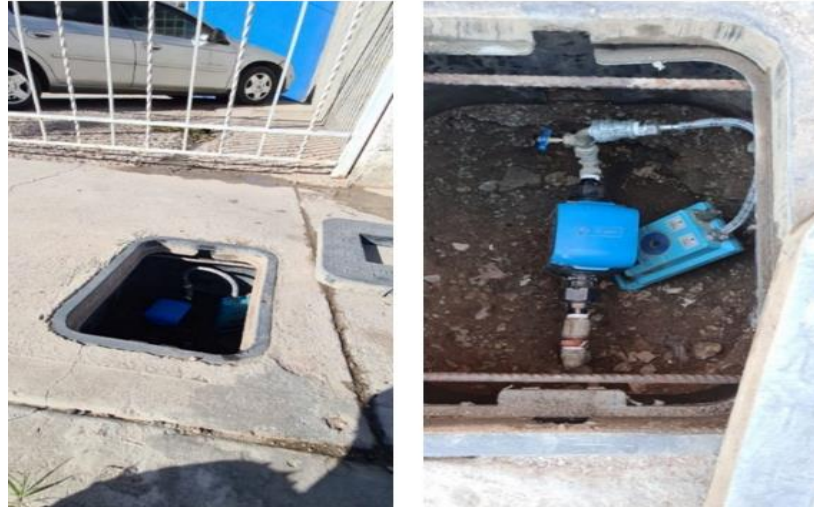
Figura 4.2 Medidor de agua ultrasónico y registrador de datos instalados en el RDS (Mendoza et al, 2022).
