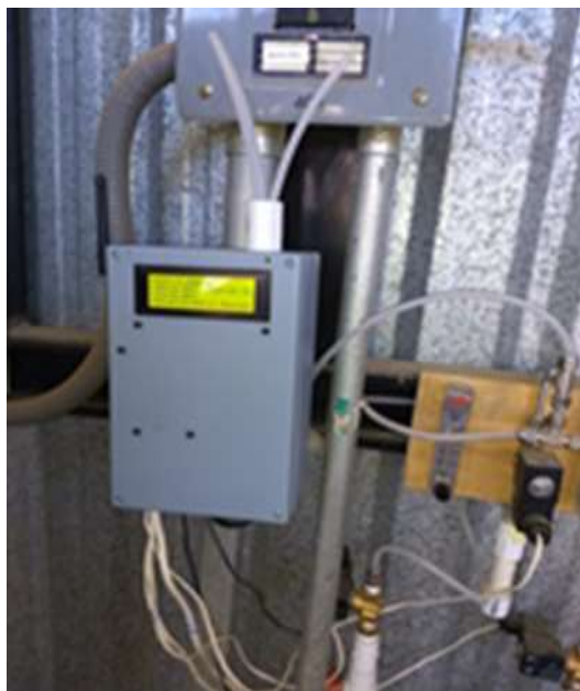
Figura 22. Sistema electrónico de detección de gases: CO 2 (%), H 2 S (ppm) y O 2 (%). El sistema estuvo compuesto por electroválvulas V2 (entrada de biogás), V1 (salida de biogás); detectores infrarrojos así como de celdas electroquímicas. La detección de gases se midió por hora: siendo la hora “par” la entrada de biogás y la hora “non” el registro de la salida de biogás.
