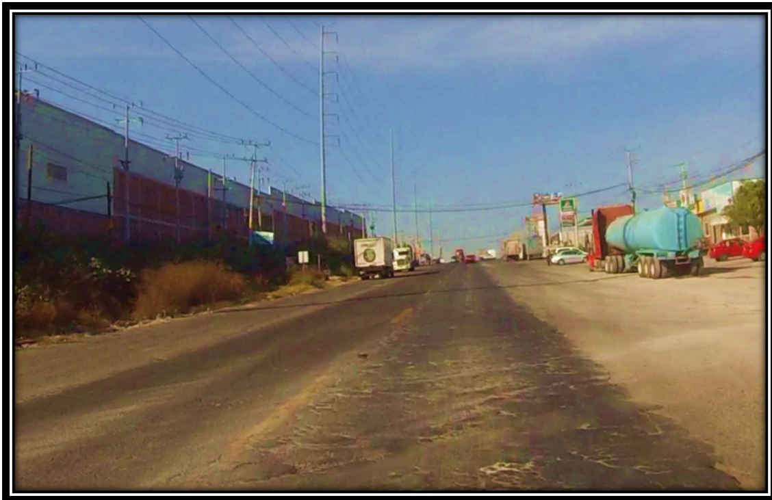
Figura 9.- Condiciones Actuales de Pavimento. Fuente: Captura en sitio.
