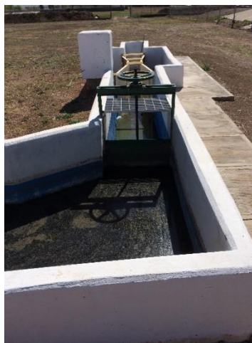
Imagen #2. Canaleta de llenado de agua a la Balsa de infiltración
