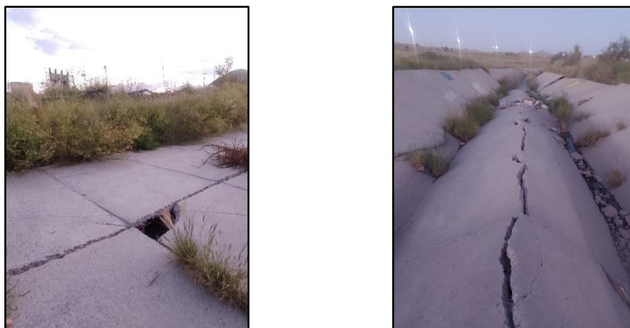
Figura 55. Fotografías del concreto abierto y levantado
