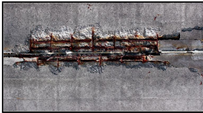
Figura 06. Alto de nivel de corrosión en el hierro de una armadura, [43].
