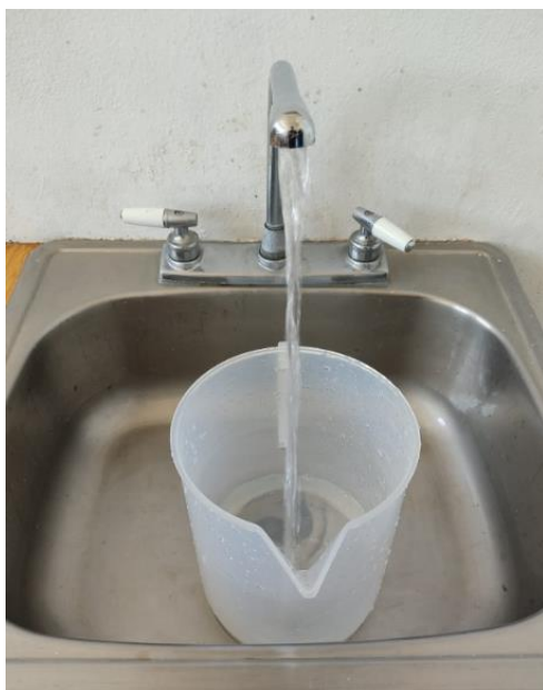
Figura 4 Aforo de instalación existente sin dispositivo para grifo
