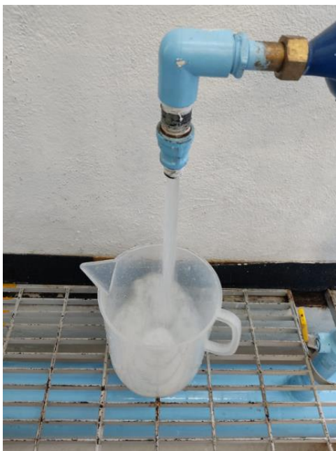
Figura 2 Aforo de instalación existente sin dispositivo para regadera
